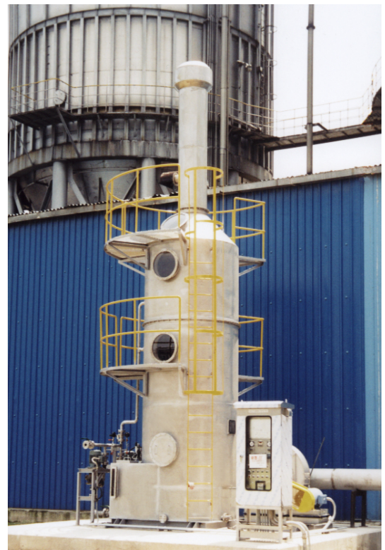
가동중인 초산 제거용 카데오 탈취장치
