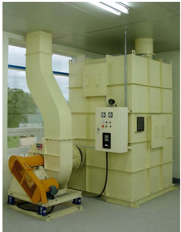
설치중인 ACTA-5 탈취장치
